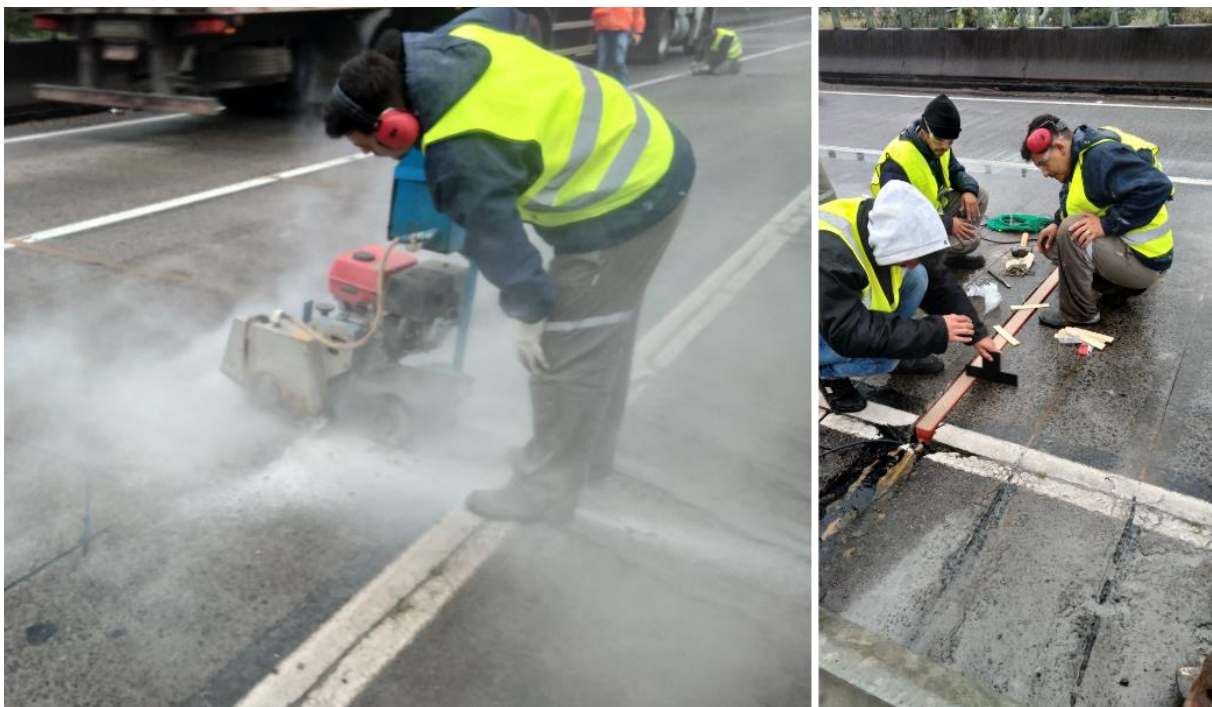
Figura 19 – Instalação e substituição sensores Consilux em Araranguá/SC
