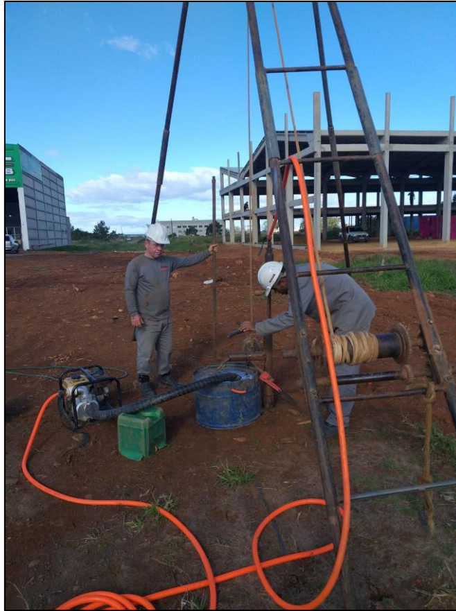
Foto 3. Execução da sondagem SPT na área de estudo durante a etapa de lavagem.
