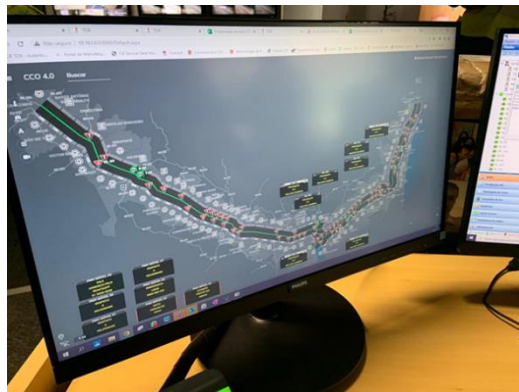
Figura 9 - Interface visual ao operador do sistema de controle das rodovias.
